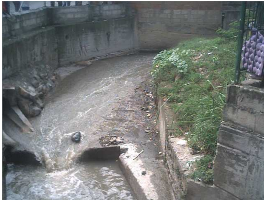
Foto 2. Descarga de aguas residuales sobre la quebrada La Herrera ubicada en la Zona Nororiental.
