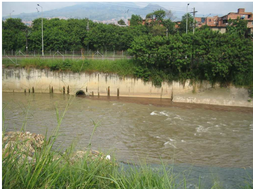
Foto 1. Descarga de interceptores centrales oriental y occidental a la altura de Moravia
