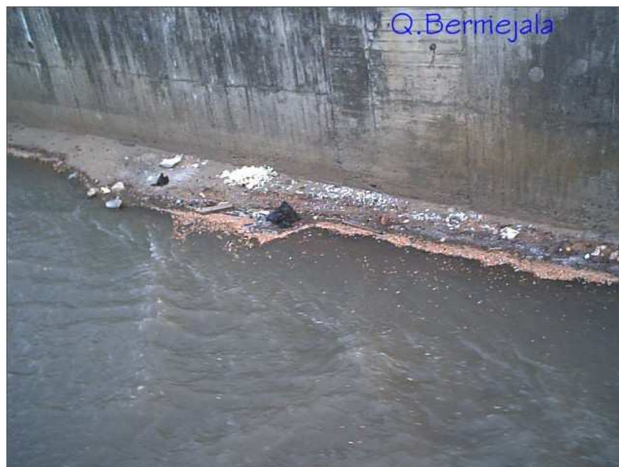
Foto 14. Residuos sólidos acumulados en el cauce de la quebrada La Bermejala.
