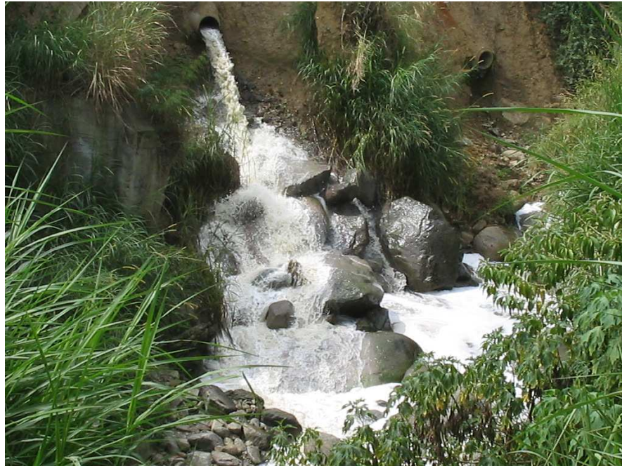
Foto 7. Descarga de un colector de aguas residuales sobre la quebrada La Madera en el municipio de Bello
