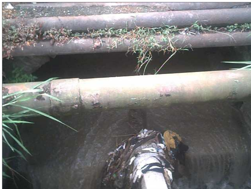
Foto 13. Residuos sólidos acumulados en el cauce de la quebrada La Herrera
